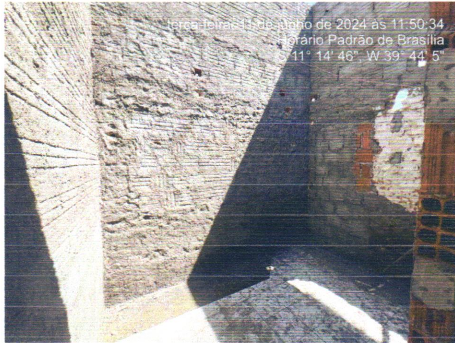
Foto 07 – CHAPISCO APLICADO EM ALVENARIA (COM PRESENÇA DE VÃOS) E ESTRUTURAS DE CONCRETO DE FACHADA, COM EQUIPAMENTO DE PROJEÇÃO. ARGAMASSA TRAÇO 1:3 COM PREPARO EM BETONEIRA 400 L. AF_06/2014
